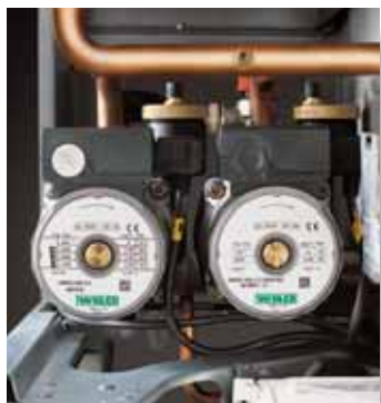
Doppie pompe dedicate, per il riscaldamento e preparazione bollitore con disaeratori incorporati
