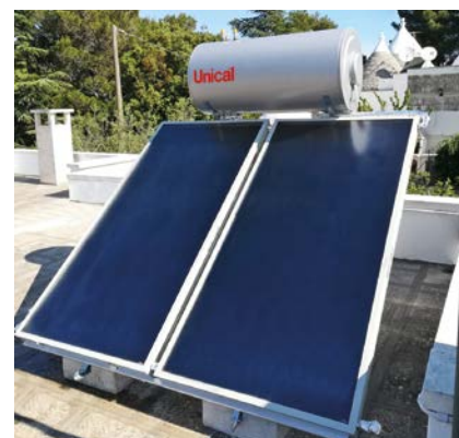
Kit installato a terra
