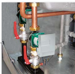
Pompes et vannes d'isolement hydrauliques
