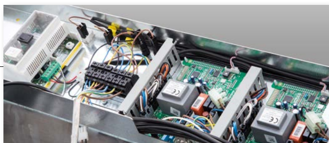
Ensemble des platines électroniques de gestion des éléments thermiques et BCM 2.0 (Boiler Control Manager)
