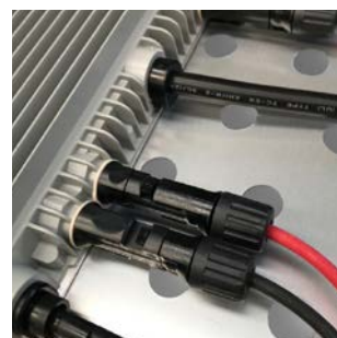
Inverter integrato nel pannello e precablato
