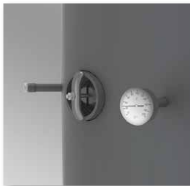
■ Thermomètre de contrôle et trappe de visite
